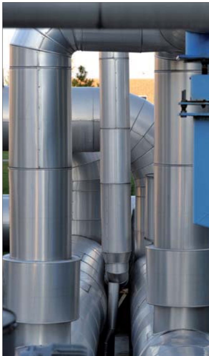
Moderne Fernwärmeversorgungsanlagen auf dem Gelände der Stadtwerke Rostock AG
