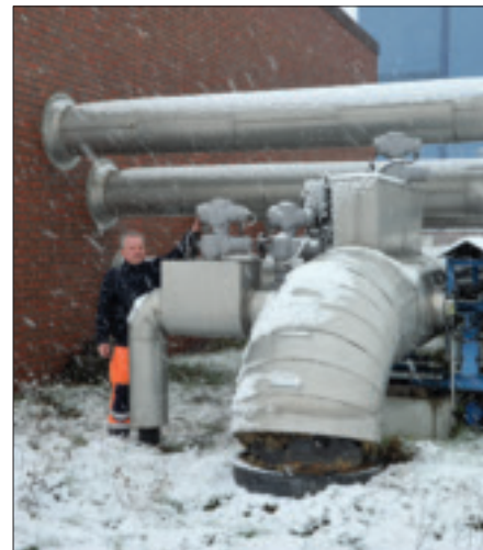
Peter Schröder bei Arbeiten an der Umwälzpumpenstation am Seehafen
