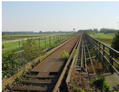
Bilder von der Kloverbrücke, im August 2004 zeigten den Erhaltungstand der Gleisanlage/ Fahrbahn. Fotos: L. Schultz
